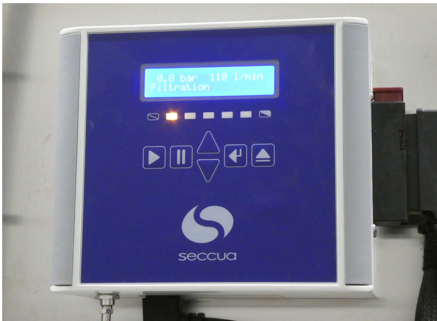
Die Steuerung der Phoenix-Ultrafiltrationsanlage passt die Spülzyklen der Wasserqualität an.
